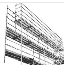
Ponteggio metallico fisso
