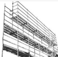
Ponteggio metallico fisso
